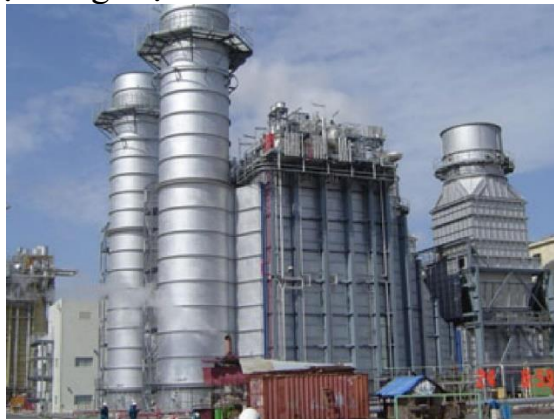
Hình 1-1. Nhà máy nhiệt điện
