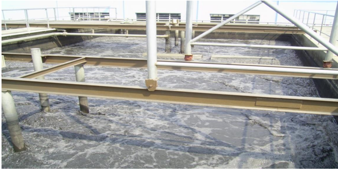
Hình 5.5: Bể SBR (Sequencing Batch Reactor) là bể xử lý nước thải bằng phương pháp sinh học
