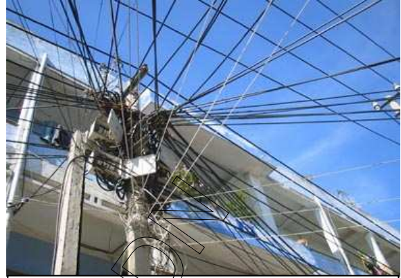
Đường dây tải điện trong đô thị hiện nay
