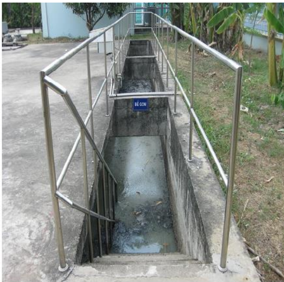
Hình 1.4: Mức nước tại bể thu gom
