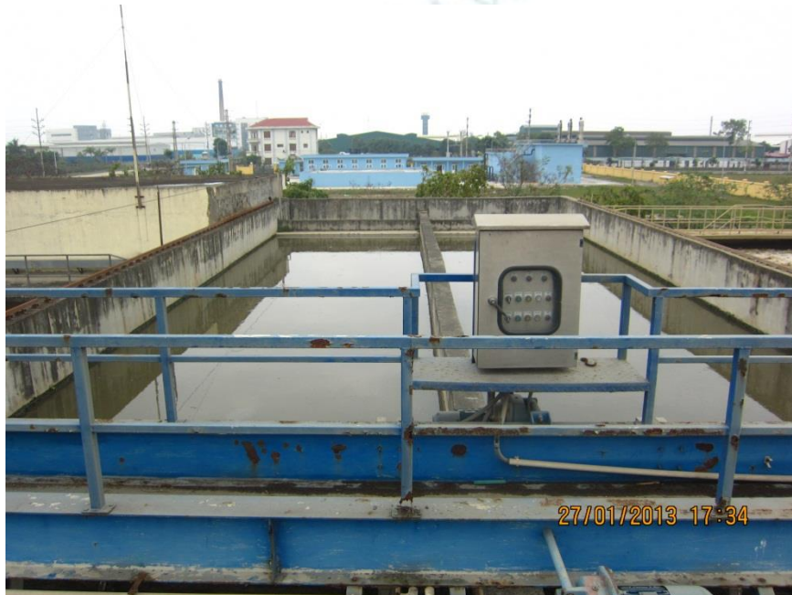
Hình 1.6: Tủ điều khiển bể lắng đợt 2
